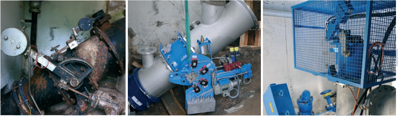
Die alte Rohrbruchsicherung DN 600 (links) wurde um das Jahr 1965 im Kraftwerk Valmara installiert. Im Jahr 2013, fast 50 Jahre nach der Installation, wurde die neue Rohrbruchsicherung (Mitte) in Betrieb genommen. Zusätzlich dazu wurde ein Staupendel mit Schutzkorb angebracht (rechts).
