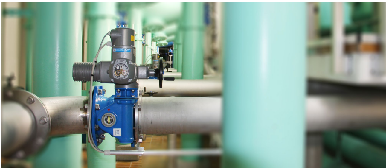
INSTALLATION IN DER TRINKWASSERAUFBEREITUNGSANLAGE IN SINDELFINGEN, DEUTSCHLAND
